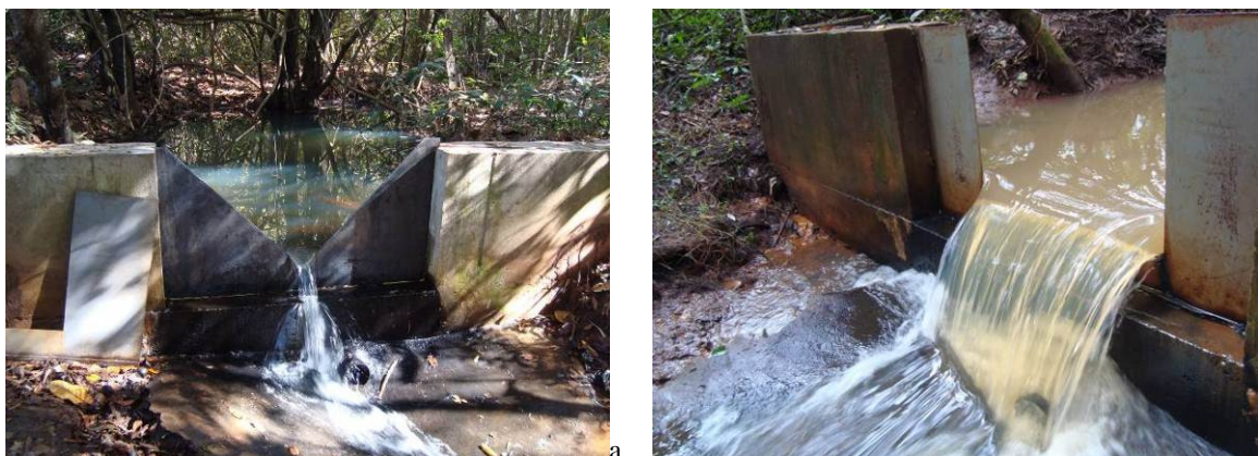
Figura 12. Vertedor em operação nas diferentes épocas do ano. Vertedor triangular – mês de agosto de 2010 (a) e retangular – mês de fevereiro de 2011 (b) de parede fina instalado no exutório da microbacia.
