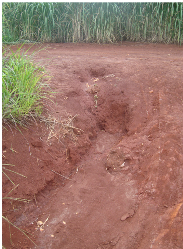
Figura 3. Erosão em sulco.
