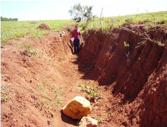
Ilustração 12 - Erosão causada pela chuva. Data da foto: 2007 Fonte: Arquivo do projeto Águas do Cerrado
