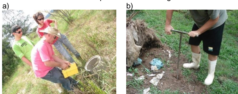
Figura 96 - a) Boca para saída de gás metano. b) Exemplo de um ponto onde havia lixo bloqueando a saída de gás metano.
