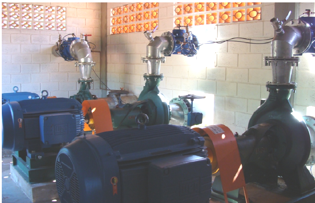
Figura 7. Casa de motobombas do sistema de fertirrigação para produção de madeira de Eucalyptus spp da Empresa MMX Metálicos Corumbá Ltda.
