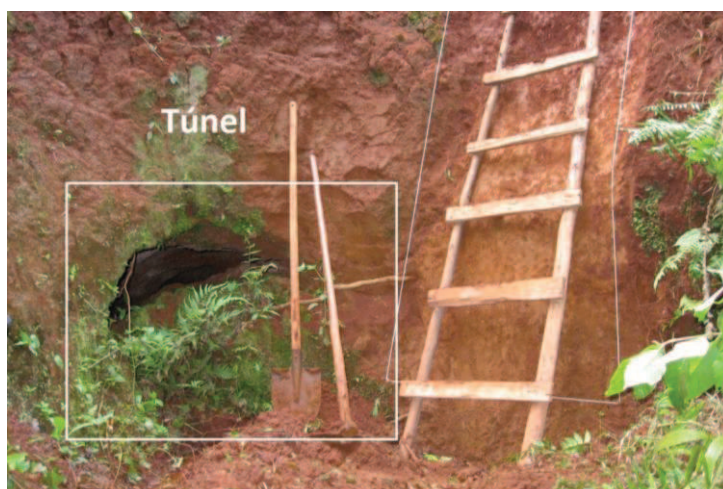
Figura 17 – Entrada do túnel parcialmente entulhada. Em destaque zona de exfiltração (olho d'água), em 18/03/2008
