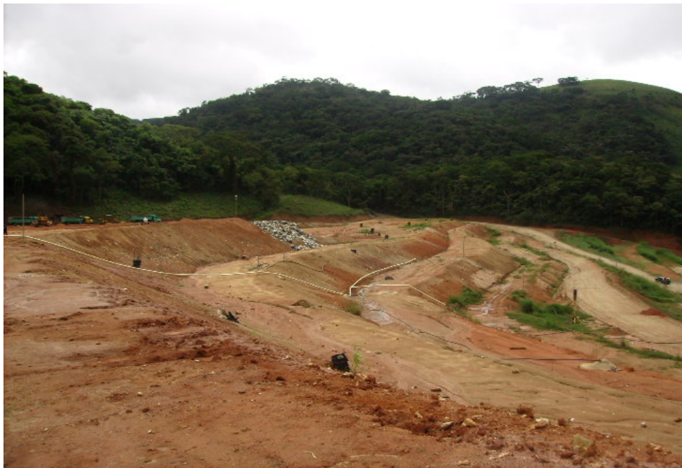
Figura 7. Vista de um aterro com os taludes desprovidos de vegetação.
