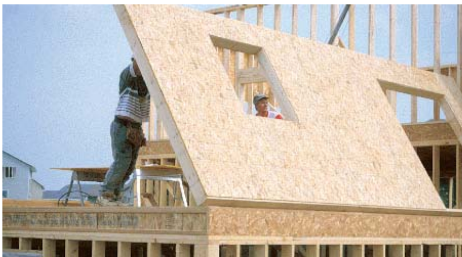
Figura 9. Levantamento de uma parede com fixação prévia das placas de OSB. Fonte: www.osbguide.com
