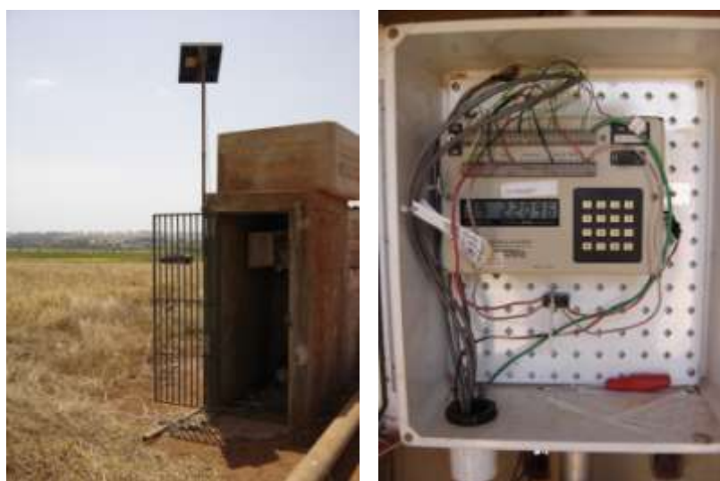
Figura 4.9 - Abrigo de alvenaria onde fica instalado o datalogger da Estação Olhos d'Água e o próprio datalogger .
