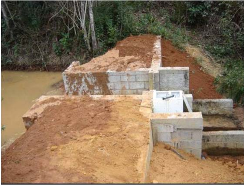
Figura 05 - Barragem construída na seção de medição da vazão na microbacia do projeto Vai e Volta.
