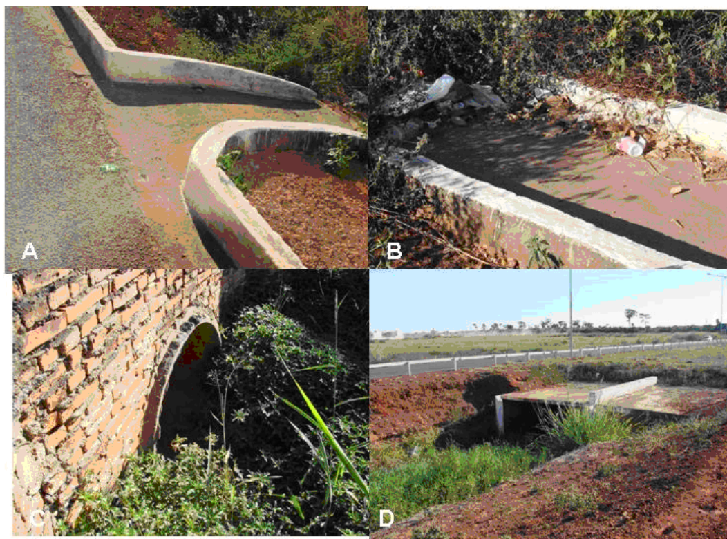
FIGURA 25 – (A, B) CAPTAÇÃO DE ÁGUAS FLUVIAIS; (C, D) TUBULAÇÃO DE DRENAGEM Fonte: GONÇALVES (2008)
