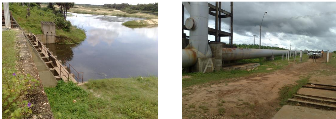
Figura 2 - Estação de Bombeamento Central. À direita temos a captação de água de rio Piranhas-Açu, e à esquerda a tubulação principal de distribuição de água. (FOTOS: Mycarla dos Santos).
