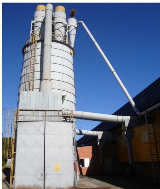
Figura 43: Silos que recebem o cavaco.
