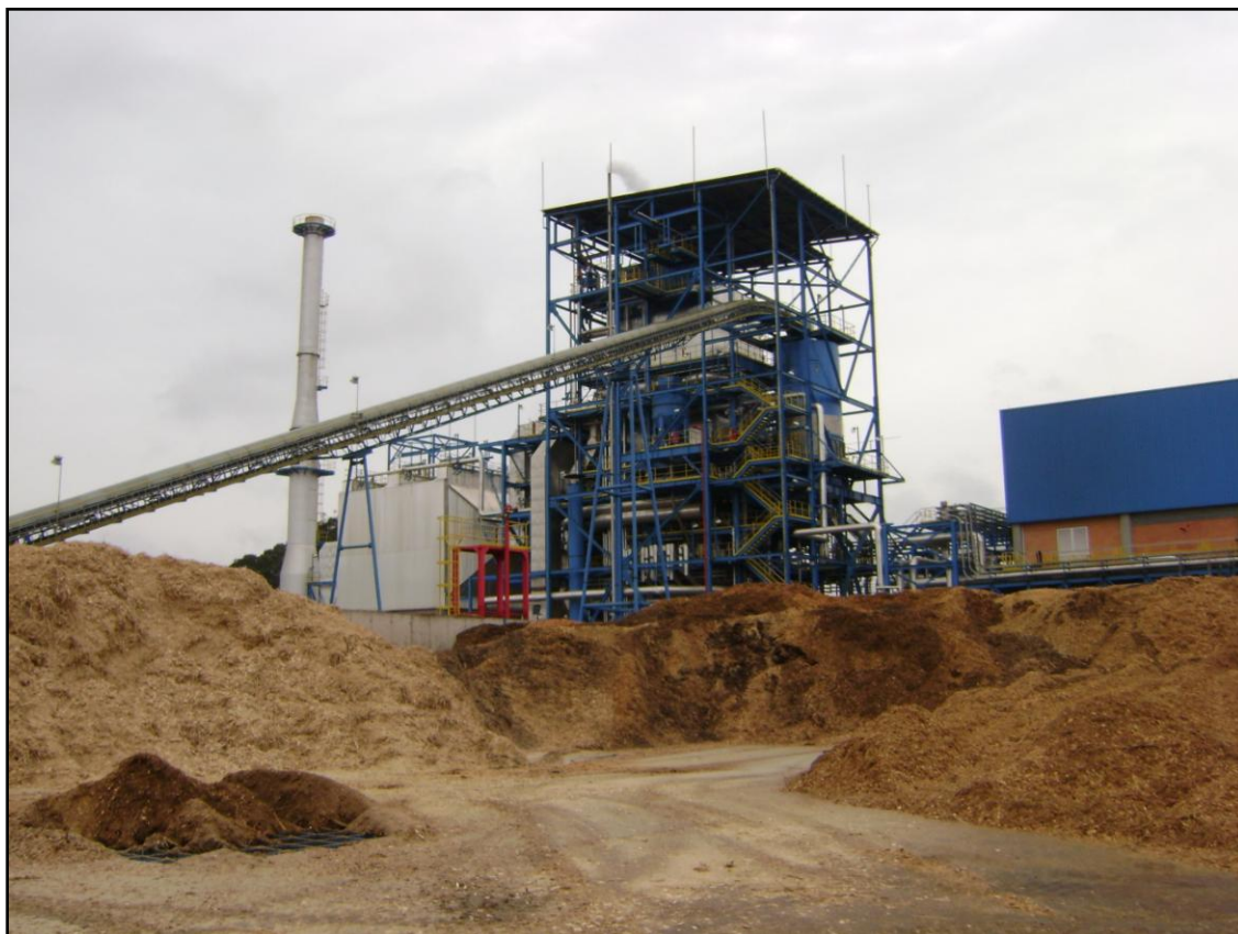
Figura 26. Instalações da caldeira de leito fluidizado e o pátio da biomassa florestal.
