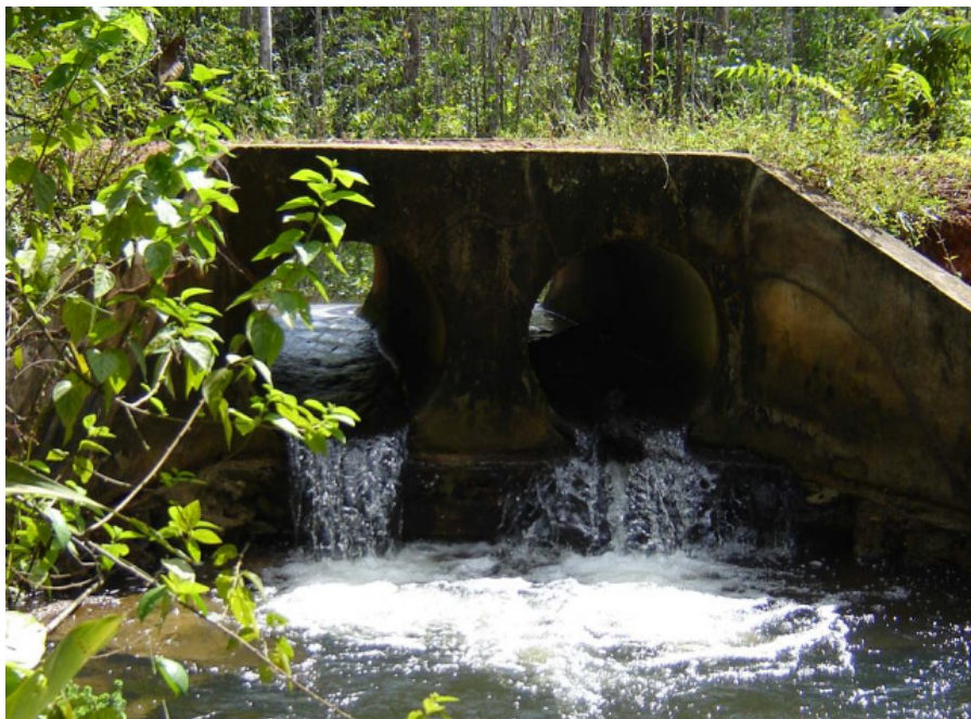
Fig. 22. Aspecto de um cruzamento de estrada sobre um igarapé. Desnível provocado pela colocação das manilhas, ocasionando queda d'água artificial à jusante do cruzamento.
