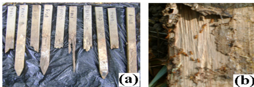
Figura 15 - Campo de Apodrecimento 1 (a) estacas deterioradas; (b) ataque de térmitas do gênero Nasutitermes .
