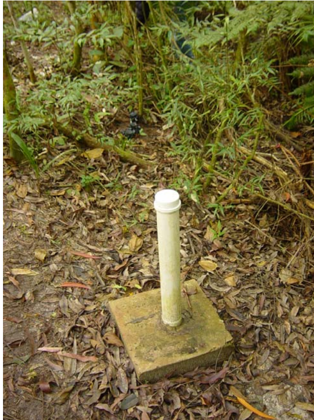
Figura 11 – Aspecto visual dos piezômetros instalados na microbacia
