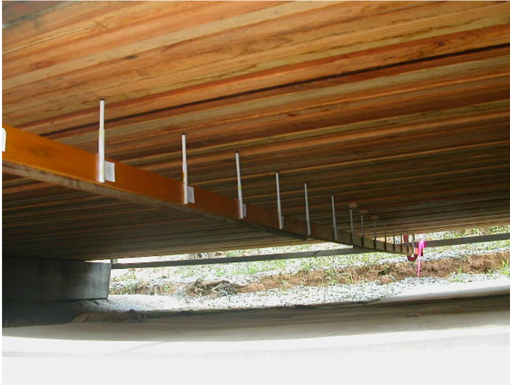
Figura 17 – Deflectômetros sob a ponte, para determinação de flechas ao longo da largura da ponte.
