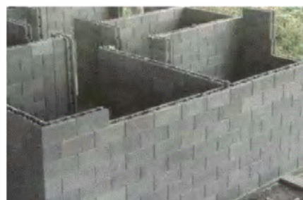
DETALHE DO SISTEMA CONSTRUTIVO FONTE: GUBER, G. Construção em blocos de concreto . 2000. 1 fot.; color.; 10 x 15 cm.
