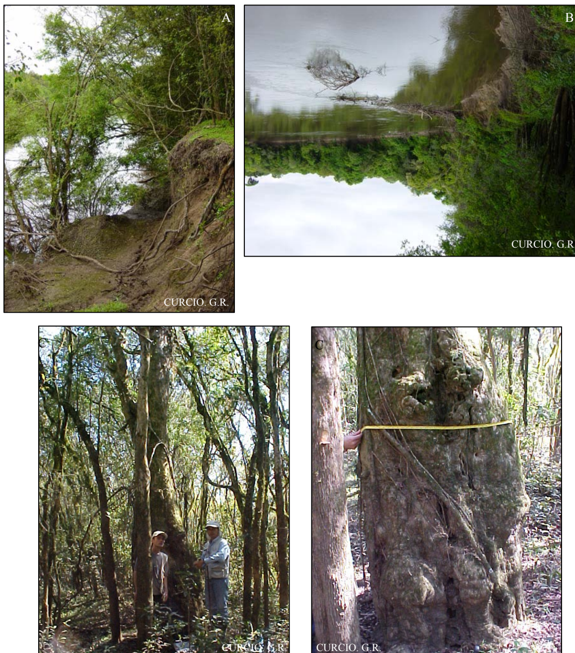
Figura 39 – A - Solapamento de margem; B – Talude angulado; C – Branquilha com 59cm de DAP.
