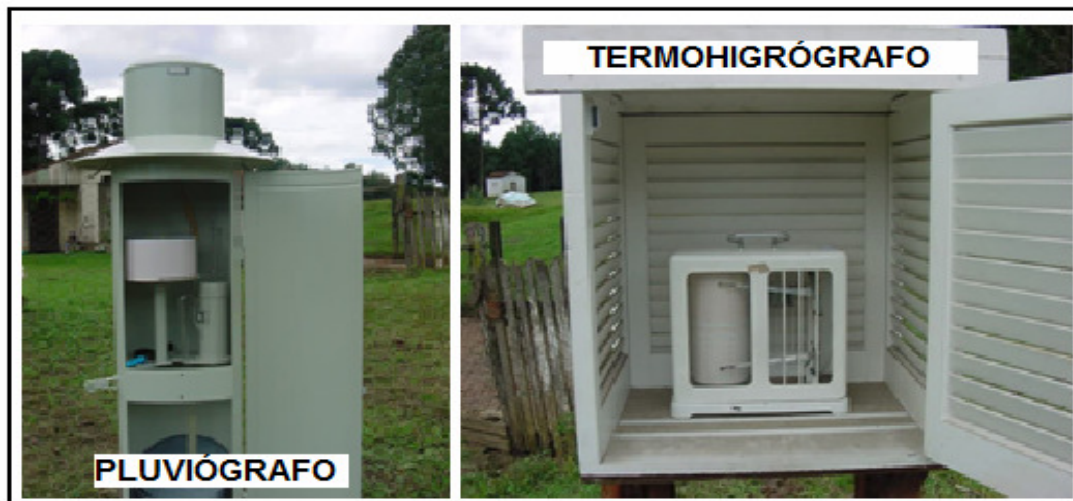
FIGURA 3.5 – PLUVIÓGRAFO E TERMOHIGRÓGRAFO INSTALADOS NA FAZENDA EXPERIMENTAL DE RIO NEGRO-PR.
