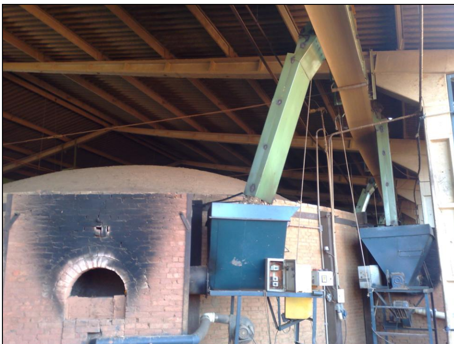
Figura 3 - Sistema de alimentação das fornalhas por meio de esteiras rolantes. Fonte: Lopes, 2012.
