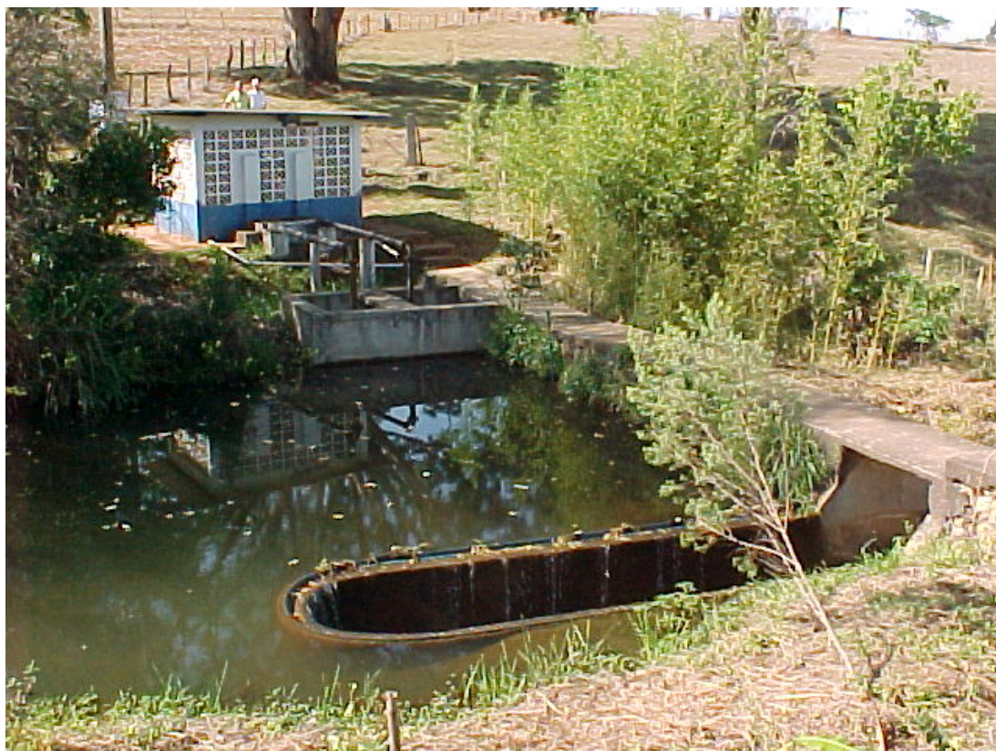
Figura 4 - Captação de Analândia no córrego do Retiro, nas cabeceiras do rio Corumbataí
