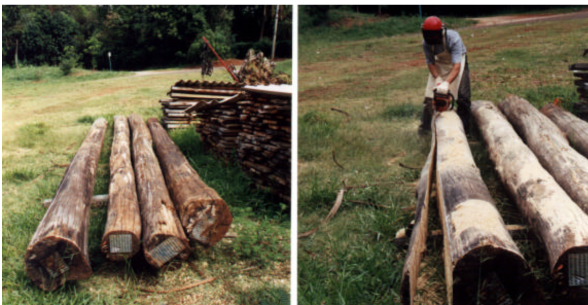
Figura 33 - Face do poste sendo preparada para melhor justaposição com o seu par.
