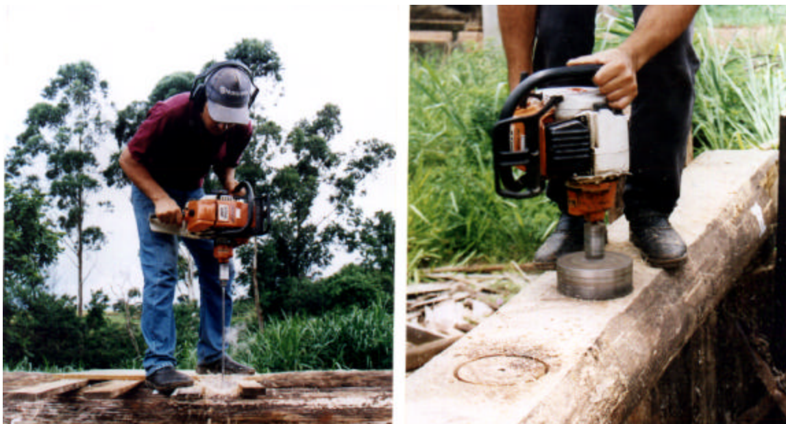
Figura 36 - Execução dos furos - guias (a) e confecção dos sulcos na madeira (b).
