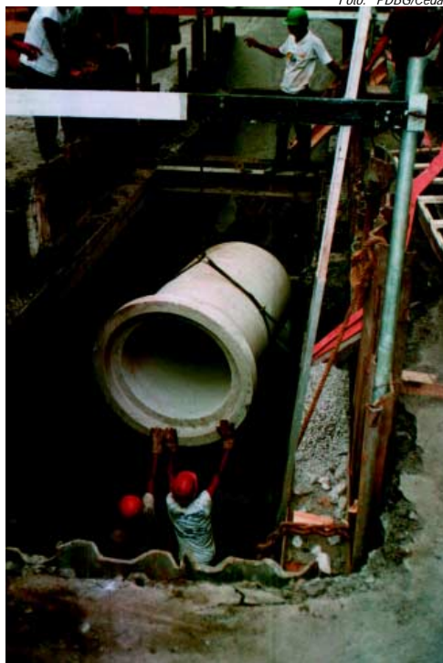
Coletor-tronco de esgotos com 1 metro de diâmetro na Ilha do Governador
