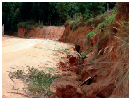
Figura 3. Perigosa vala de erosão em estrada rural municipal, em Campinas, SP. Foto: Paulo Espíndola Trani, 2005 (Instituto Agrônômico, SP)
