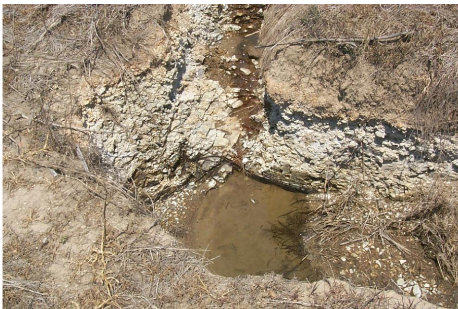
Figura 83 – Detalhe da intensidade da erosão em sulco, da figura anterior.
