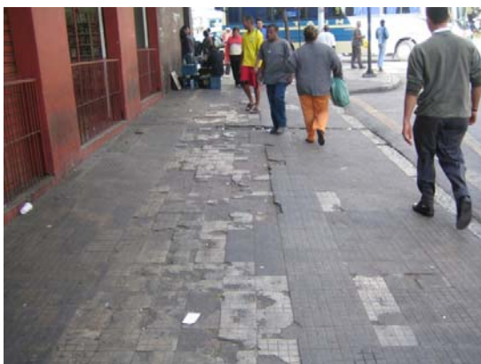
Figura 3.15. Calçadas danificadas e sem padronização. Fonte: Prefeitura Municipal de Belo Horizonte, 2007:12.
