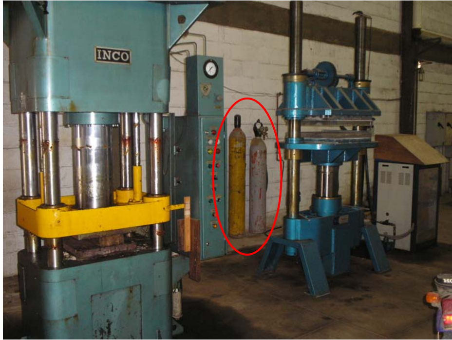
Figura 26 – Cilindros sem amarras de segurança (galpão de máquinas)
