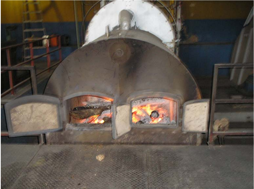
Figura 15 – Caldeira a vapor com combustível sólido
