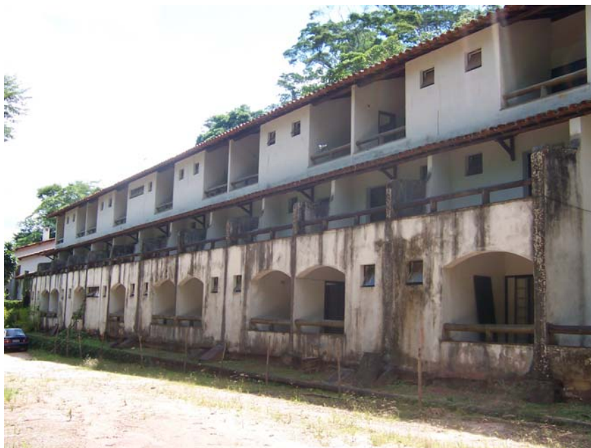
Foto 35: Fachada do Hotel Poços de Fervedouro, mostrando as marcas de seu estado de abandono.
