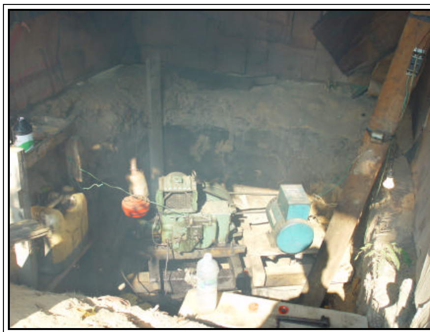
Figura 10 – Grupo gerador movido a diesel, localizado em área residencial da Vila Céu do Mapiá, responsáveis pela emissão de gases poluentes e elevados níveis de ruídos.
