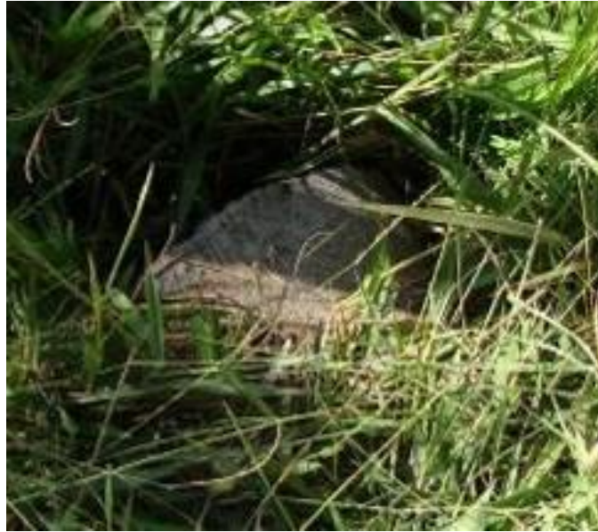
Figura 17 – Manilha de concreto situado no ponto 12.
