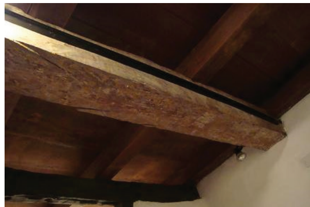
Figura 6 – Aspectos das rupturas da viga avaliada no Sobrado Ramalho.
