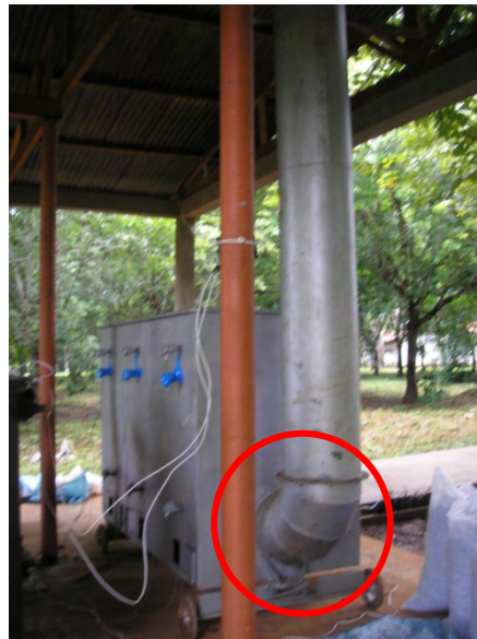
Figura 21 – Detalhe do cotovelo de união com o trocador de calor e do flange para desmontagem da chaminé.
