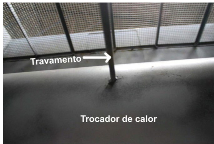
Figura 20 – Detalhe do travamento do trocador de calor no interior do secador.
