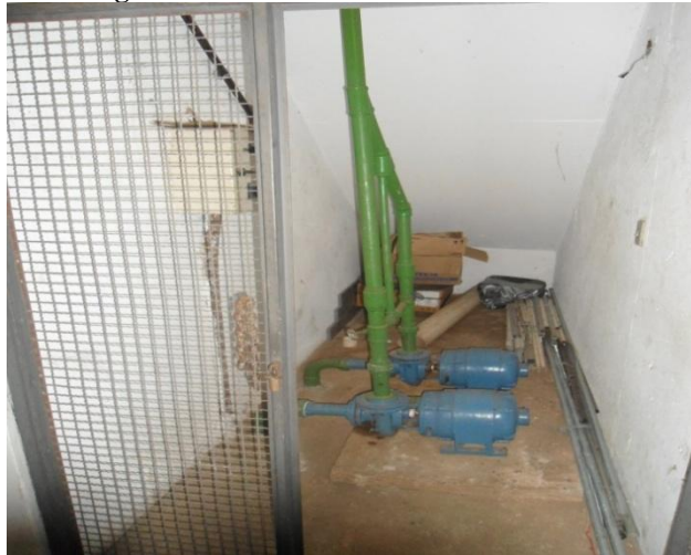
Figura 5 – Sistema de bombeamento.
