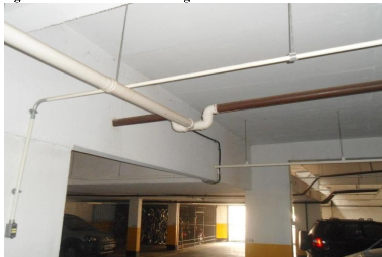
Figura 3 – Condutores onde a água é levada até o reservatório.
