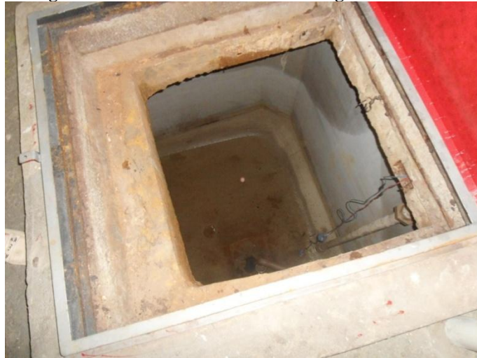
Figura 4 – Reservatório da coleta de água da chuva.
