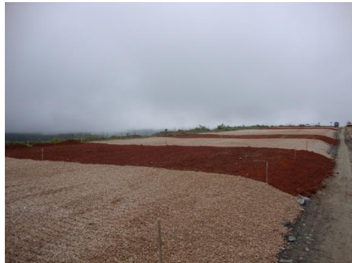
Fotografia 2. Instalação das camadas de quebra de capilaridade (10 cm) formadas por brita calcária e laterita.
