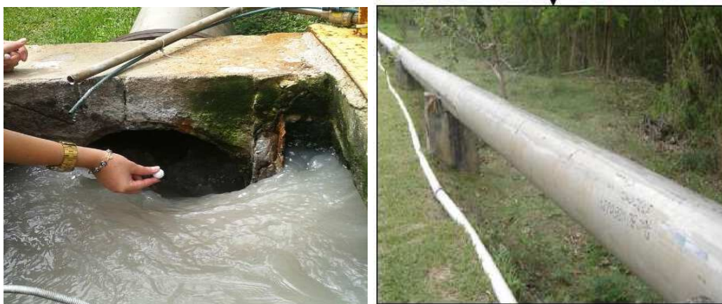
Figura 6 – Ponto de aplicação de bolinhas de isopor e tubulação que leva efluente do decantador para a lagoa aerada N2, onde foi estimado a vazão da ETE SANTHER pelo método flutuador.
