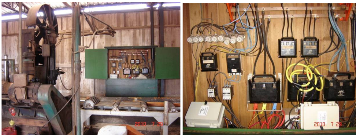
Figura 45. Serra de fita vertical e quadro de distribuição na Serraria C.
