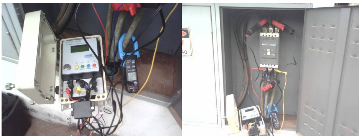
Figura 44. Vistas do Analisador Portátil Saga 4000 e o Alicates Wattímetro Digital MINIPA ET-4090 ambos ligados junto à entrada de energia da Serraria C.
