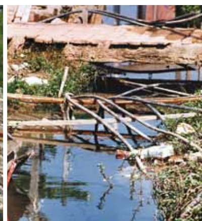
CAPTAÇÃO CLANDESTINA DE ÁGUA. Fonte Sabesp.
