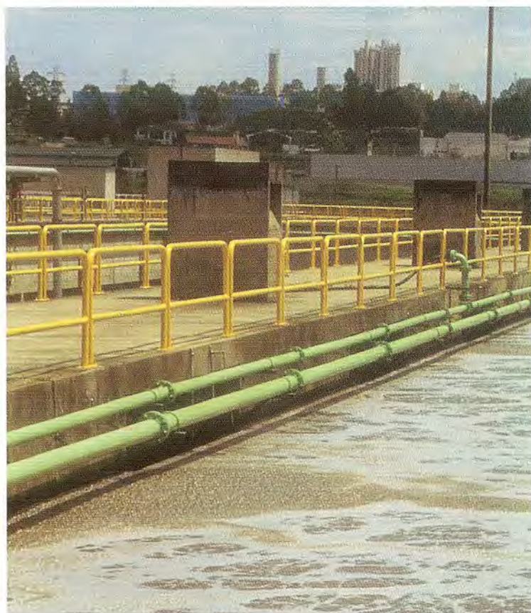
Lagoa de arejamento da estação da Sabesp em Barueri (SP) utilizada para tratamento do lodo proveniente de esgotos
