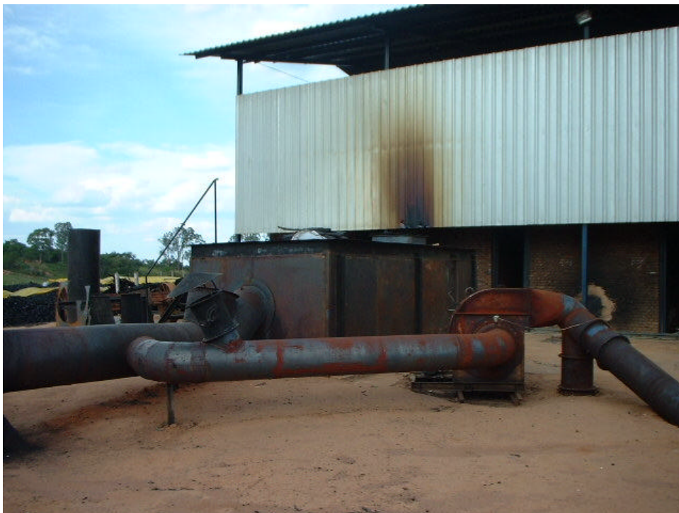
Figura 2A – Vista geral do queimador de fumaça.
