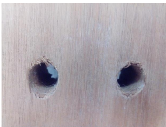
Figura 20. Deformação na madeira causada pelo elemento de ligação
